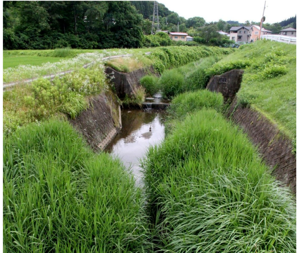
↑ 川床はコンクリートの3面護岸なのですが...、堆積砂礫に繁茂した植生に育まれて?
